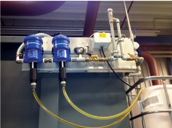
01 Installation von 2 x LDT Dosatron Dosierern in Reihenschaltung
