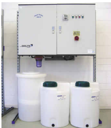
Anlage zur Produktion des Desinfektionsmittels
